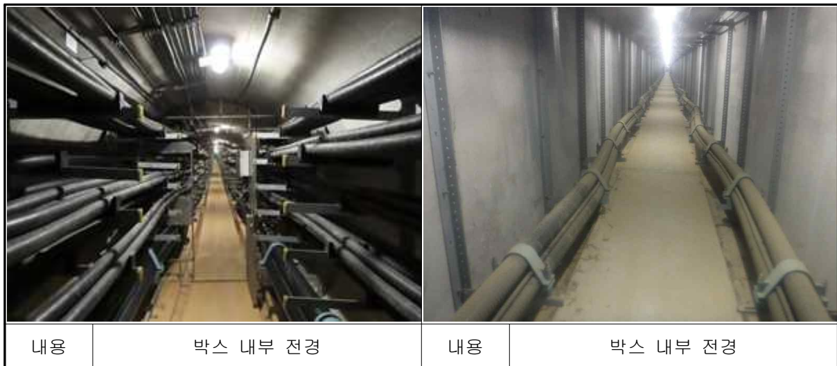
[사진 10.1] 신파주분기 전력구 현황
